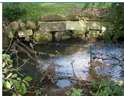
Confortements de berges nombreux
